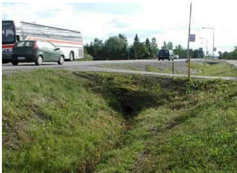
Slika 6.13 Nevaren cestni prepust
