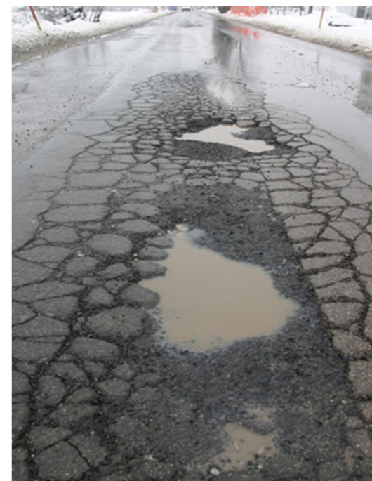
Poškodovano vozišče - vzrok za nastanek povečanega števila nevarnih situacij
